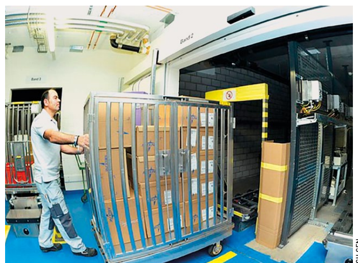
Die verschiedenen Gebäude des USB und des UKBB sind unterirdisch mit über 4,5 Kilometer langen Gängen verbunden. In diesen sind die Warenaustransportsysteme – MTA für Container und STA für Behälter – sowohl für Vertikal- als auch für Horizontaltransport installiert.
