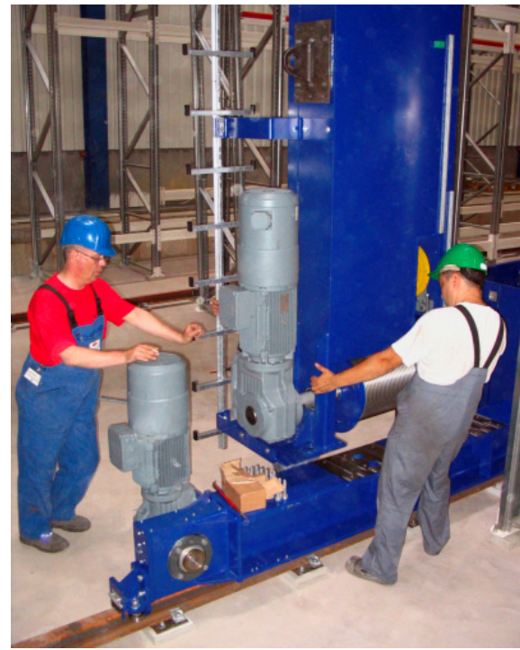
Montage eines Regalbediengerätes.
