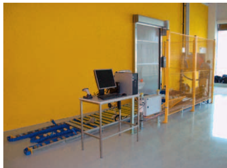
Auslagerung vom Hochregallager - Fördertechnik Wareneingang/-ausgang Konfektionierung
