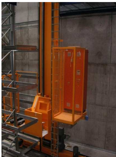
Die Hubbühnen der beiden RBG wurden umgerüstet, damit nebst EURO-Paletten auch breitere geführt werden können.
