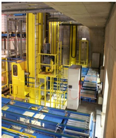
Die fertig produzierten Waren werden im modernisierten Hochregallager fachgerecht eingelagert und just-in-time innerhalb von 24 Stunden an jeden Ort in der Schweiz zuverlässig ausgeliefert.
